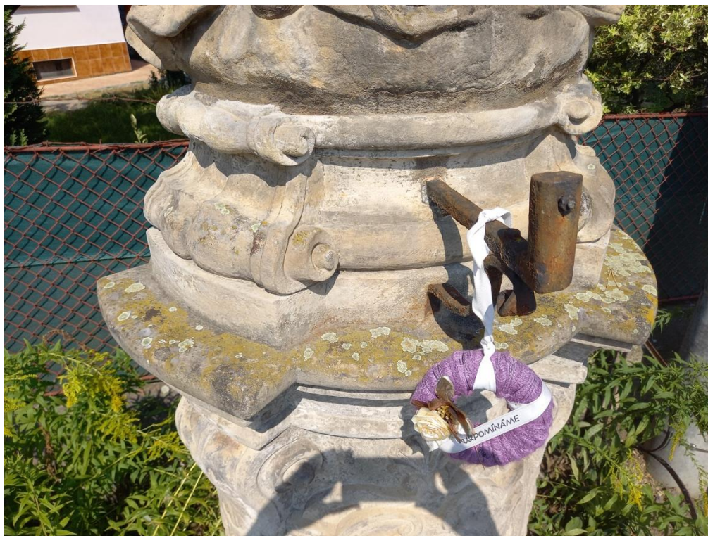
Sousoší piety, Prostějov-Vrahovice, pohled na římsu se silným napadením biodepozity, prachovými nečistotami, v popředí zkorodovaná konzola lucerny – stav před restaurováním
