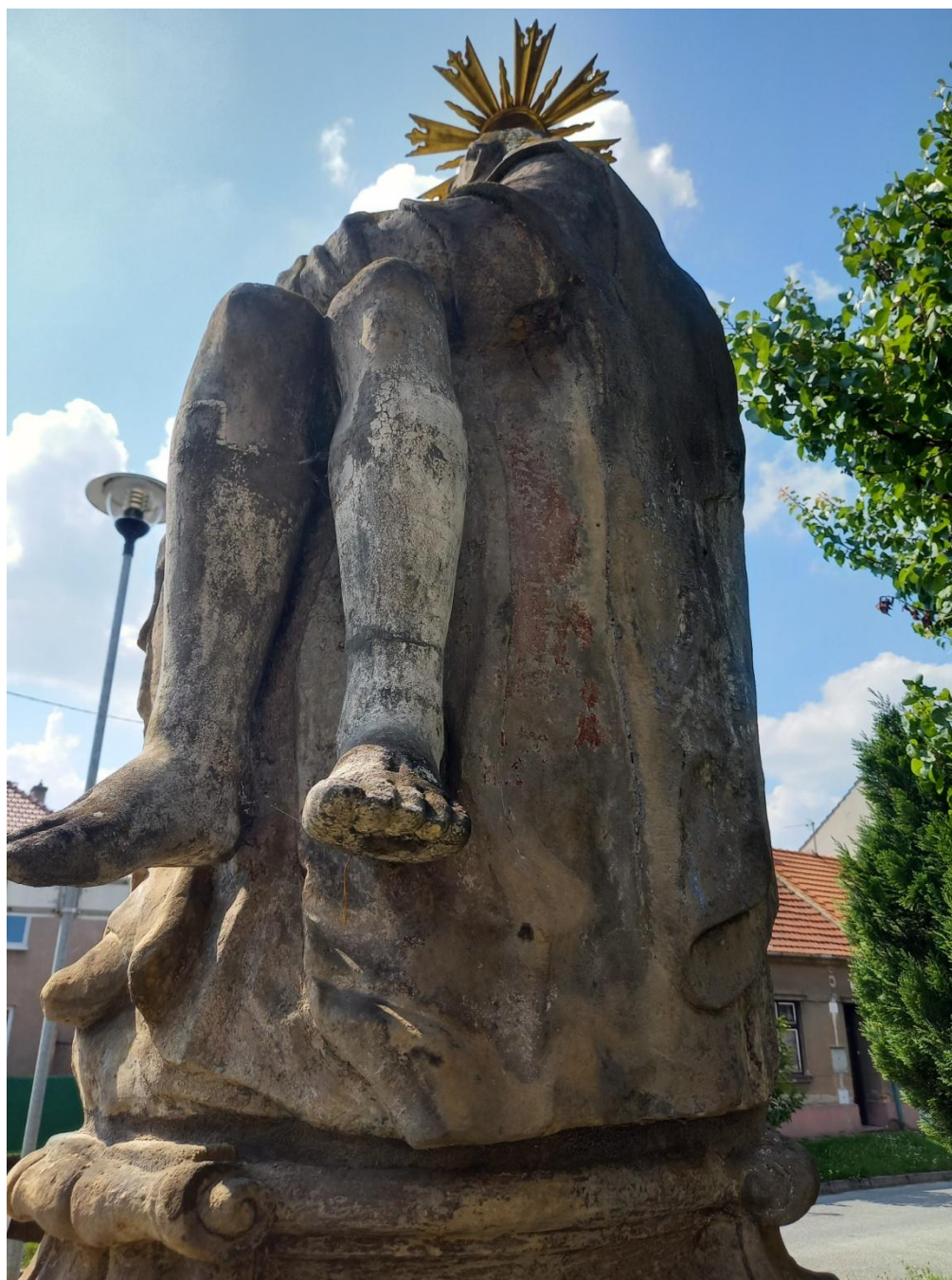
Sousoší piety, Prostějov-Vrahovice, detail Kristových nohou, patrné praskliny nebo spáry (jedná se o kopie) a znečištění biodepozity a černými usazeninami – stav před restaurováním
