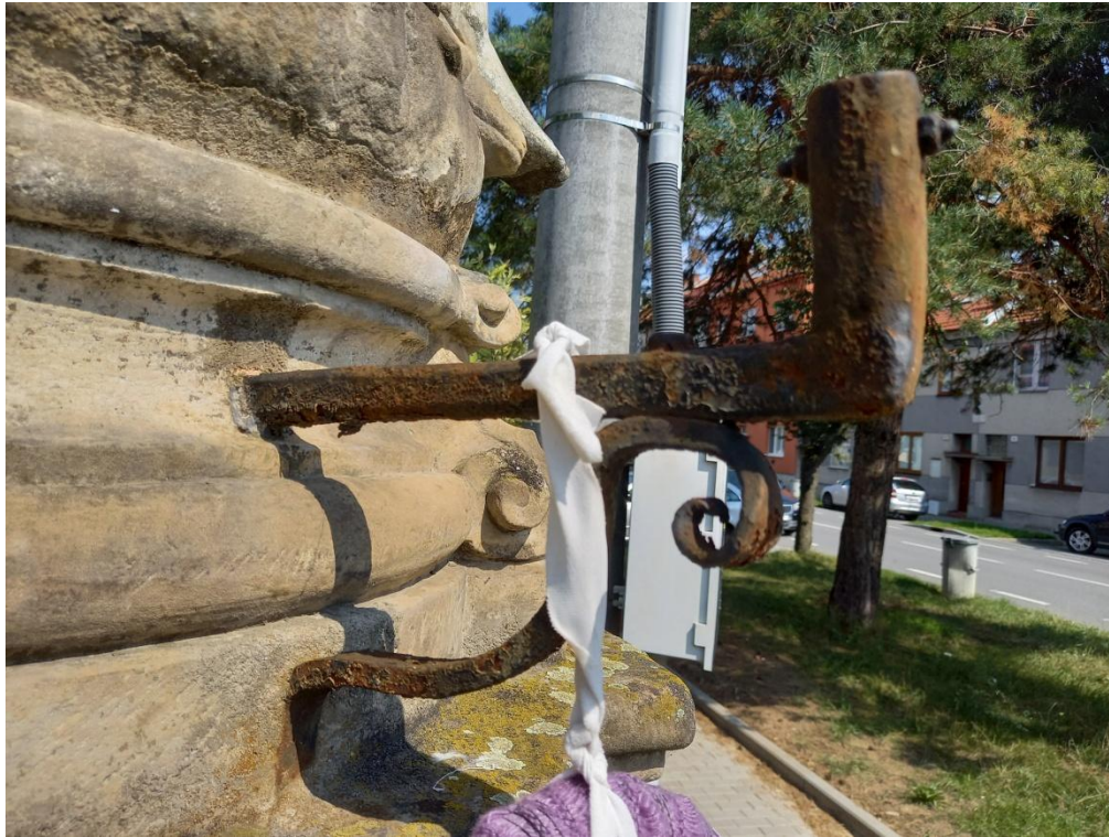
Sousoší piety, Prostějov-Vrahovice, detail zkorodované konzoly lucerny – stav před restaurováním
