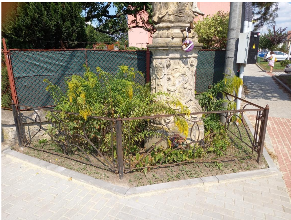
Sousoší piety, Prostějov-Vrahovice, novodobá kovová ohrádka napadená povrchově rží – stav před restaurováním
