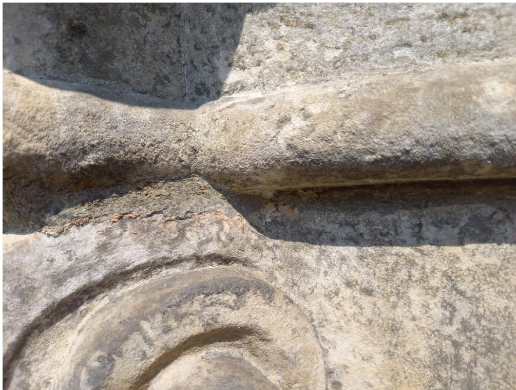
Sousoší piety, Prostějov-Vrahovice, detail profilace podstavce, patrné fragmenty barevné povrchové úpravy, kolem znečištění – stav před restaurováním
