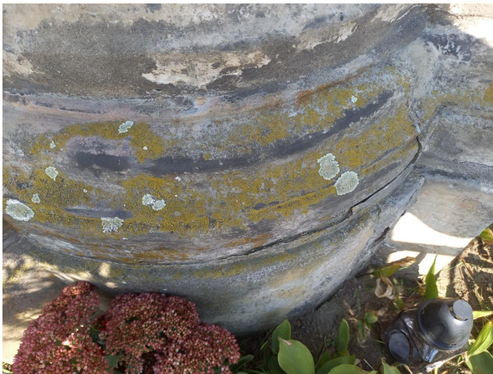
Sousoší piety, Prostějov-Vrahovice, detail profilace soklu podstavce, patrné dožilé doplňky a spárování, dále silné znečištění biodepozity a prachovými depozity – stav před restaurováním
