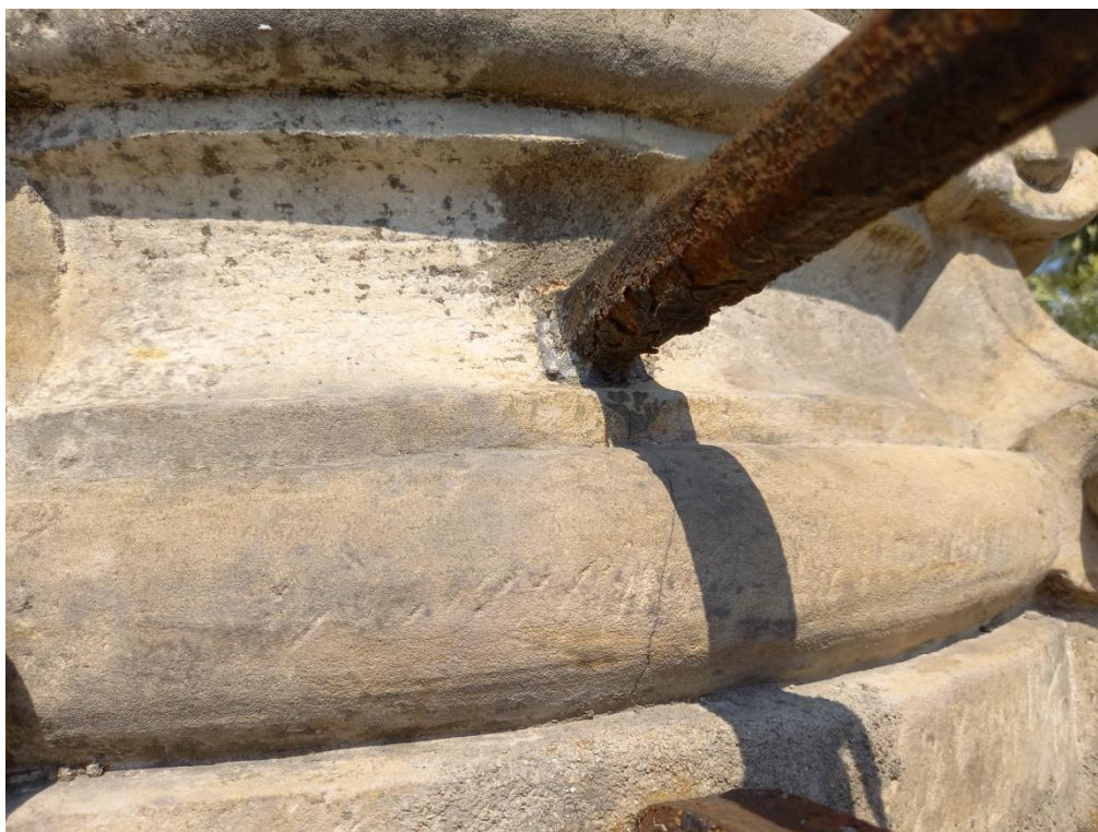
Sousoší piety, Prostějov-Vrahovice, pohled na uchycení zkorodované konzoly lucerny, od něj směrem dolů vede prasklina – stav před restaurováním
